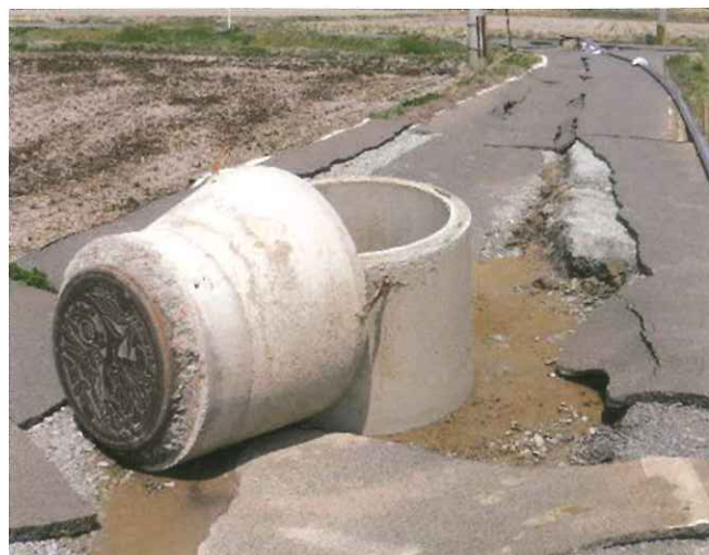
東日本大震災によるマンホールの浮き上がり被害(東北地方内陸地域)
